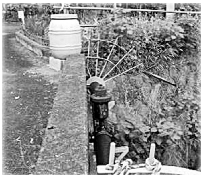
水漏れしている空気調整弁（今山）
