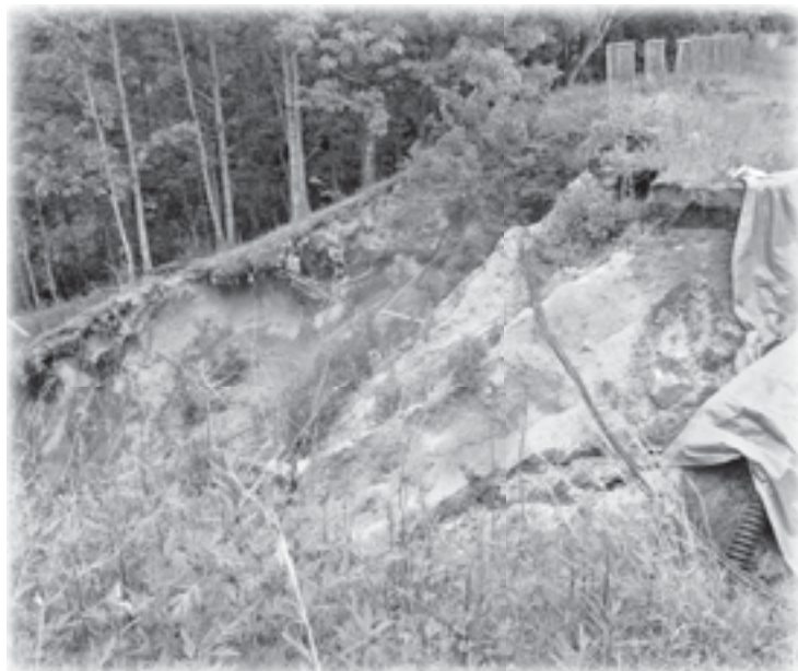
総合グラウンドの法面崩壊（東端）
