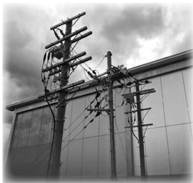
引込柱の電気設備（保育所）
