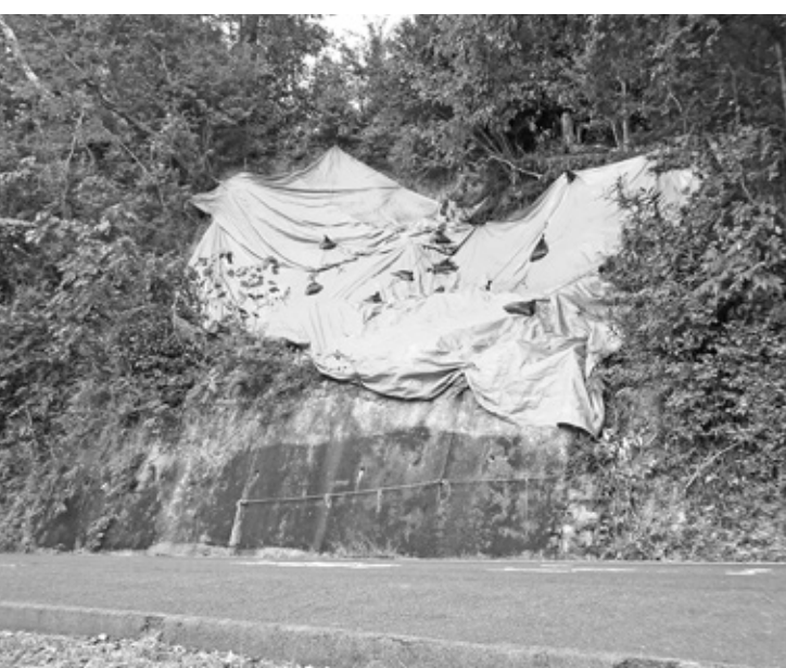
府道月ヶ瀬今山線法面の崩壊（田山）
