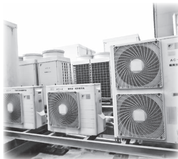
保育園エアコン室外機
