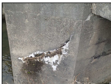
■ コンクリートのひびわれ-1
