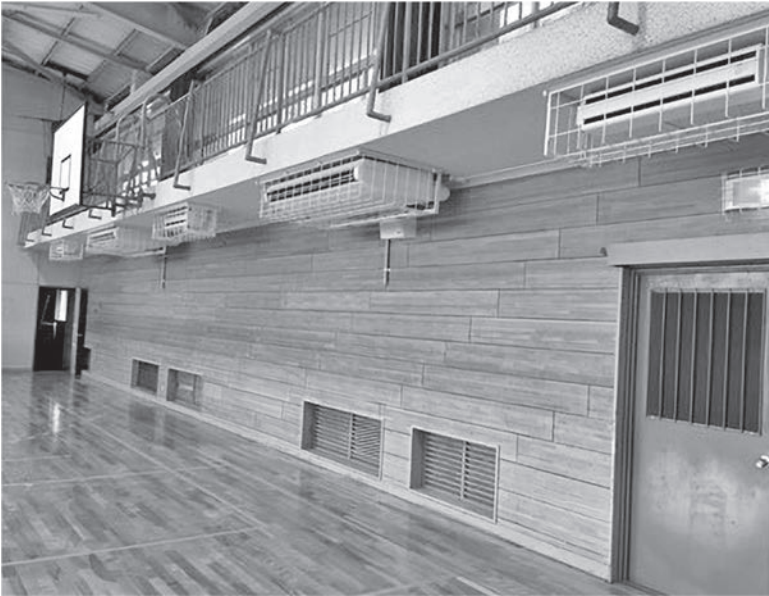
村の体育館にもエアコンを（設置済みの八幡市の学校）
