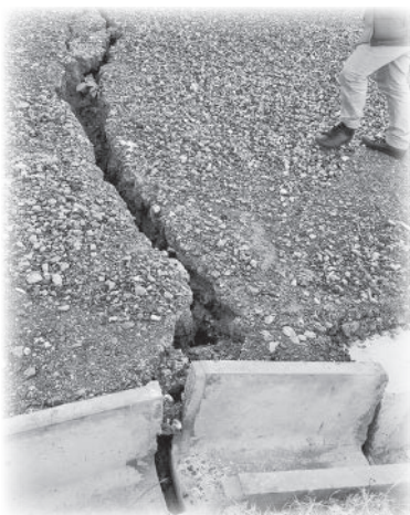
工事後亀裂が生じたクリーンセンター(和東町)
