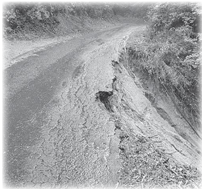
南大河原高尾線、路肩崩壊（南大河原）
