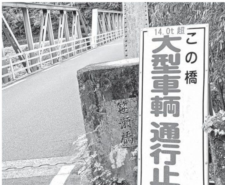
架け替えが必要な笹瀬橋
