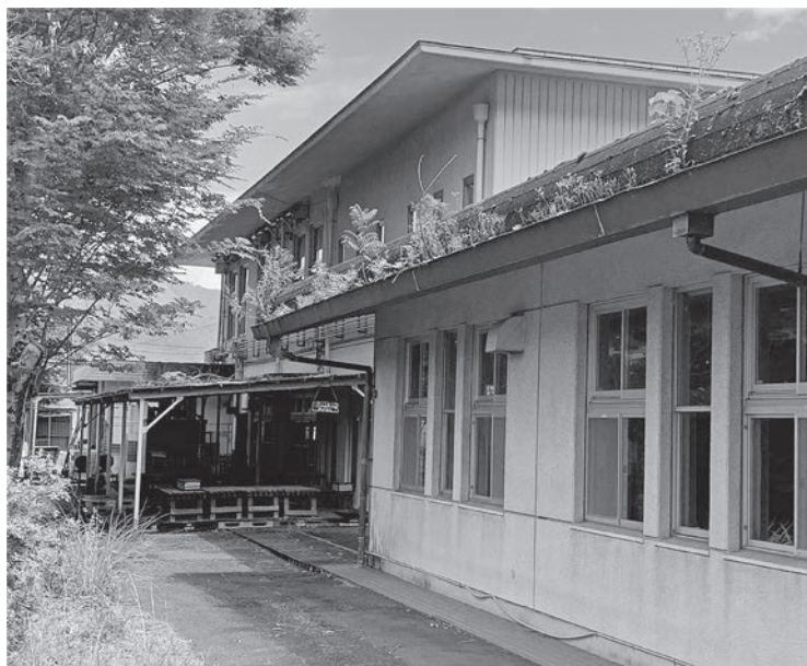
老朽化が進む旧自然の家（田山）
