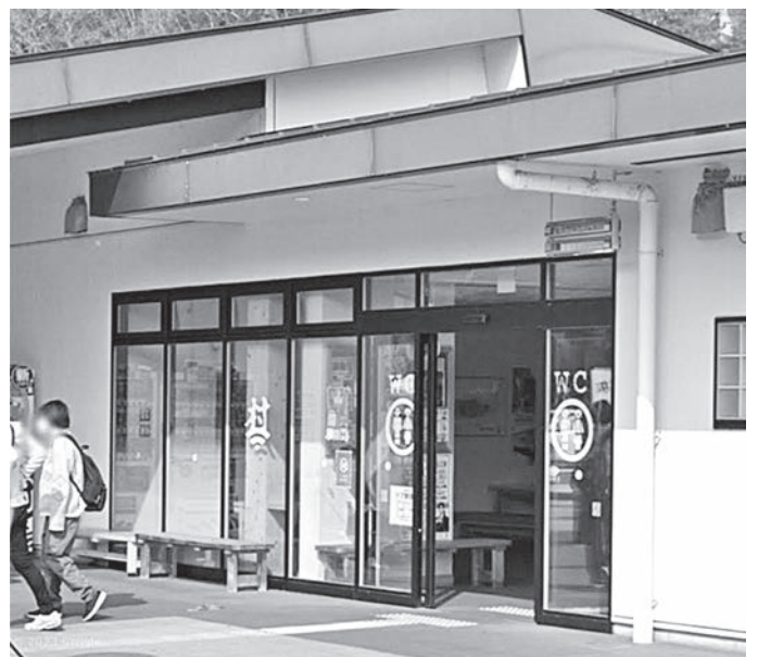
村は、4年間も監視カメラの修理を放置
