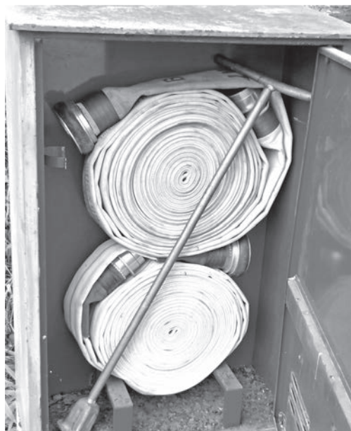
筒先が盗難された消火栓BOX（NT）
