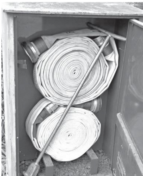
筒先が盗難された消火栓BOX（NT）
