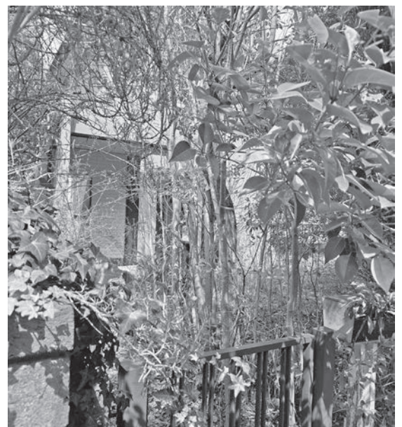
手入れが出来ていない空き家 (NT)
